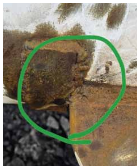
Рис. 3. Трещина (l – 20 мм) в месте крепления раскосов к стойке прожекторной площадки нижней секции стрелы Fig. 3. Crack (l – 20 mm) at the place where the braces are attached to the rack of the searchlight platform of the lower section of the boom
